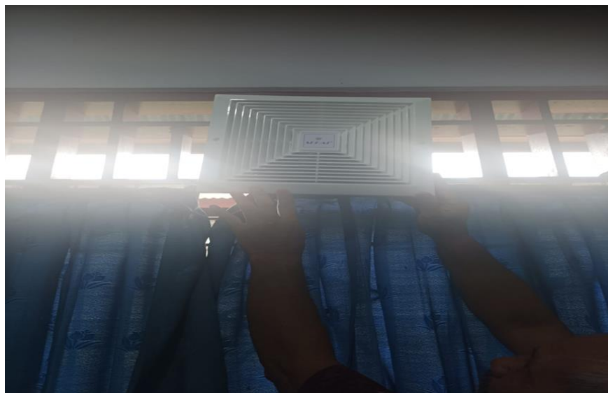
Gambar 5. Pemasangan blower/exhaust fan (pengisap udara dari dalam keluar ruangan laboratorium tempat menyimpan bahan kimia
